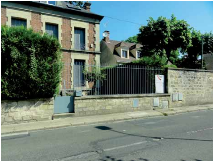
Continuité de clôture, végétaux, mur en pierre, muret et grille mais présence significative de nombreux coffrets encastrés.
